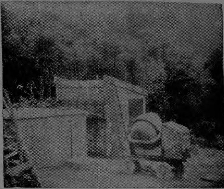
ESTACION DE BOMBEO PARA EL ALTO DE LA TRINIDAD DE MORAVIA.—El Servicio Nacional de Acueductos y Alcantarillado, preocupado por el abastecimiento de agua de todos los sectores del cantón de Moravia, construyó en La Trinidad la estación de bombeo y el tanque que puede verse en la foto. Desde ahí se impulsará el agua para ofrecer un buen servicio a los abonados de El Alto de La Trinidad.
